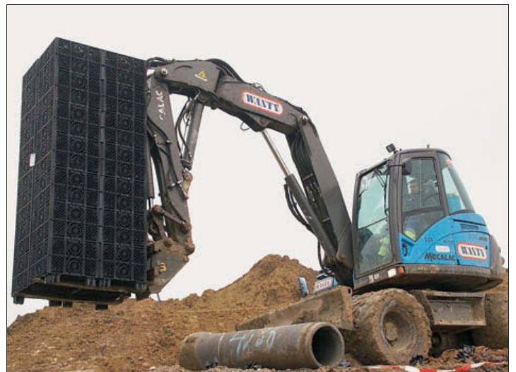
De kratten worden in de infiltratieput geladen, zodat er zo weinig mogelijk manueel werk vereist is
